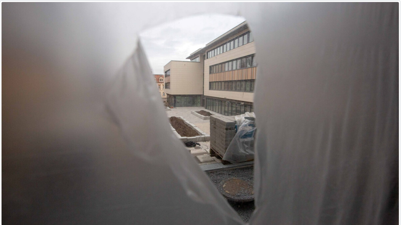
Blick aus dem Verbindungstrakt: Noch sind die meisten Fenster mit Folie geschützt. © Matthias Schumann
